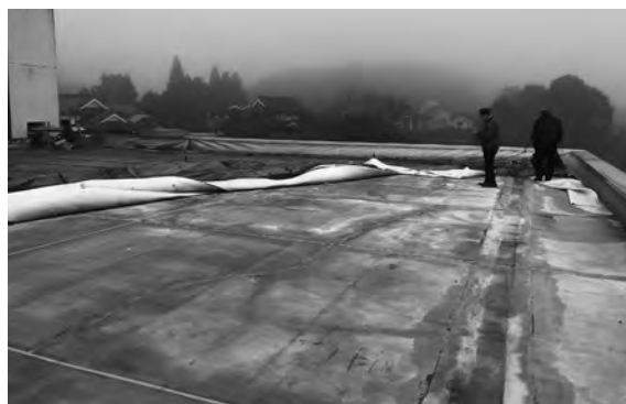
▲屋上の剥がれたシート
