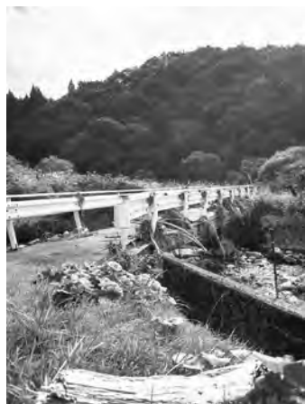
被災箇所の橋
