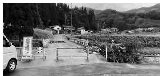
大石大木山橋（上齋原）損壊現場
