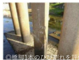
◎橋脚1本のひび割れを評価
